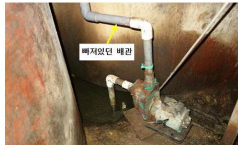
빠져있던 배관 집수조 폐수펌프
