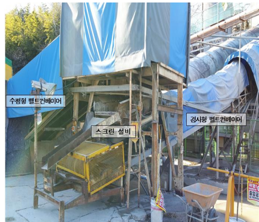
재해발생 장소(수평형 벨트 컨베이어 끝단, 스크린 설비)
